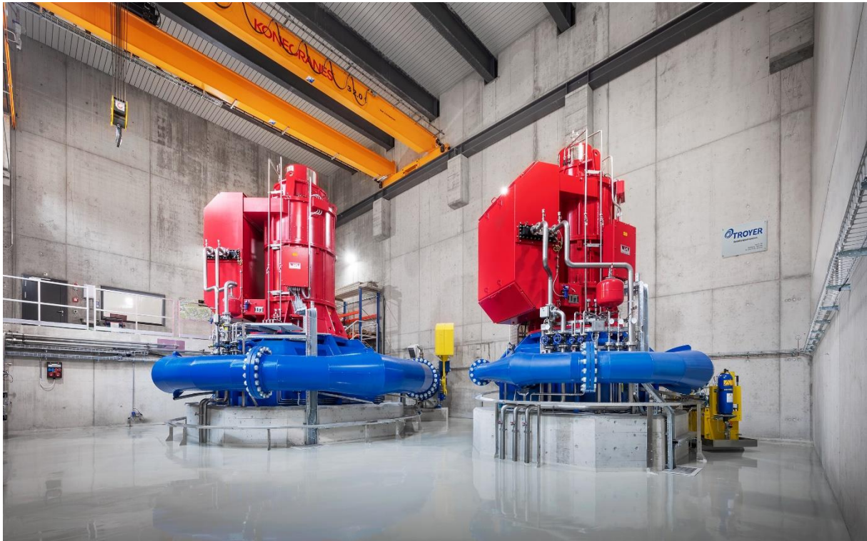
Anlage "Gere", Obergoms, Schweiz, Baujahr 2020
